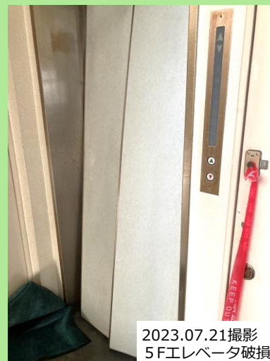
2023.07.21撮影 入口ドアが吹き飛ば
